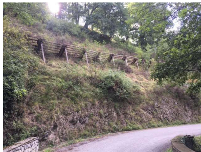
Claies paravalanches en bois au dessus de la RD112
