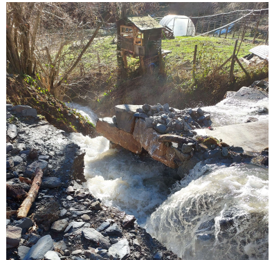
Dégâts des eaux du ruisseau de Lita Estros durant la crue de janvier 2022.
